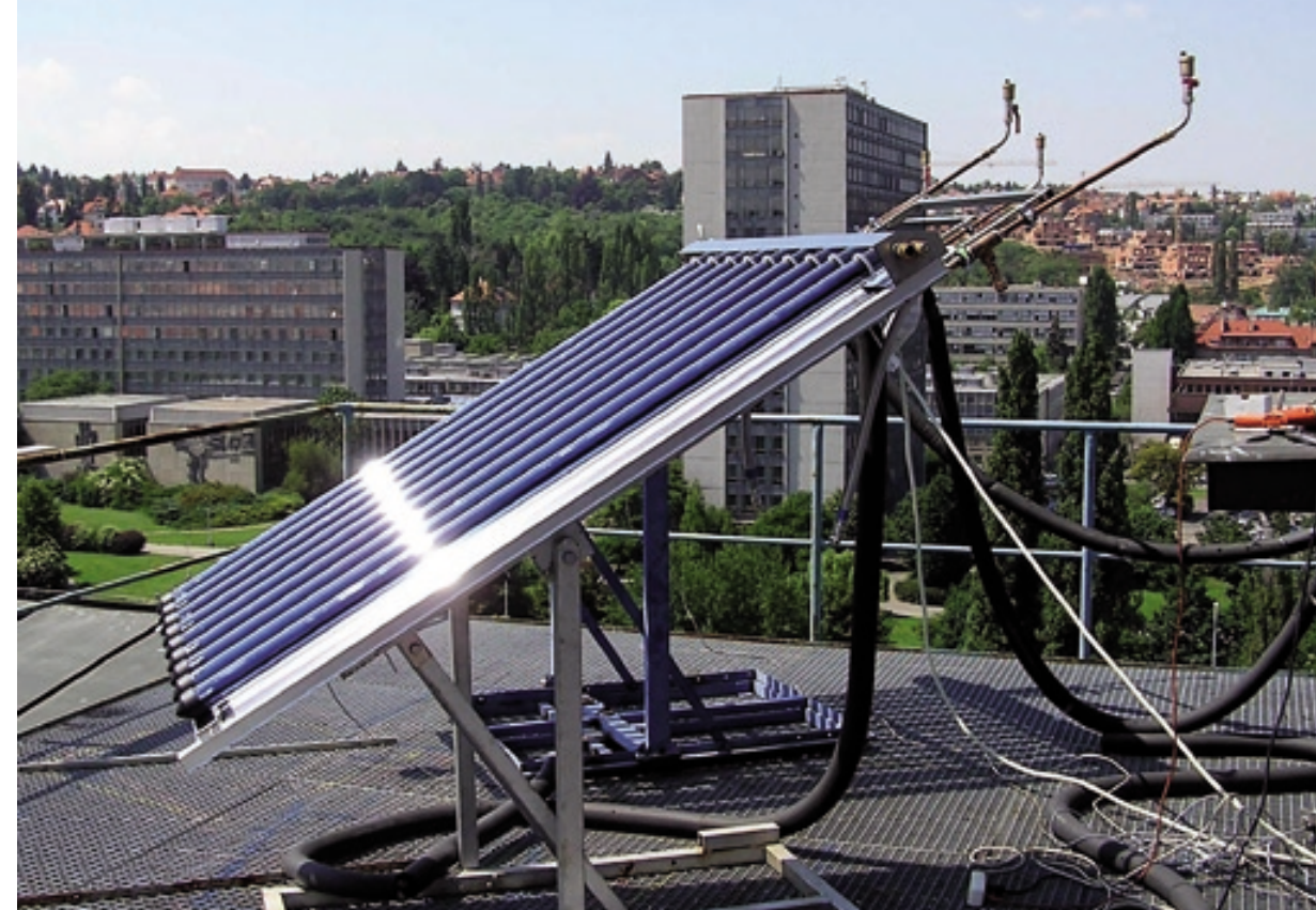
Solární kolektor na střeše Fakulty strojní napojený na měřicí okruh
