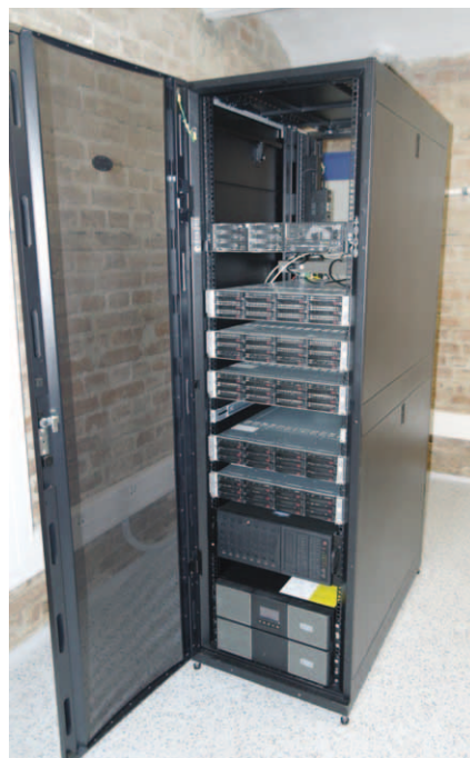
Skříň s novým počítačovým clusterem situovaným v suterénní serverové místnosti v budově FJFI v Trojanové ulici
